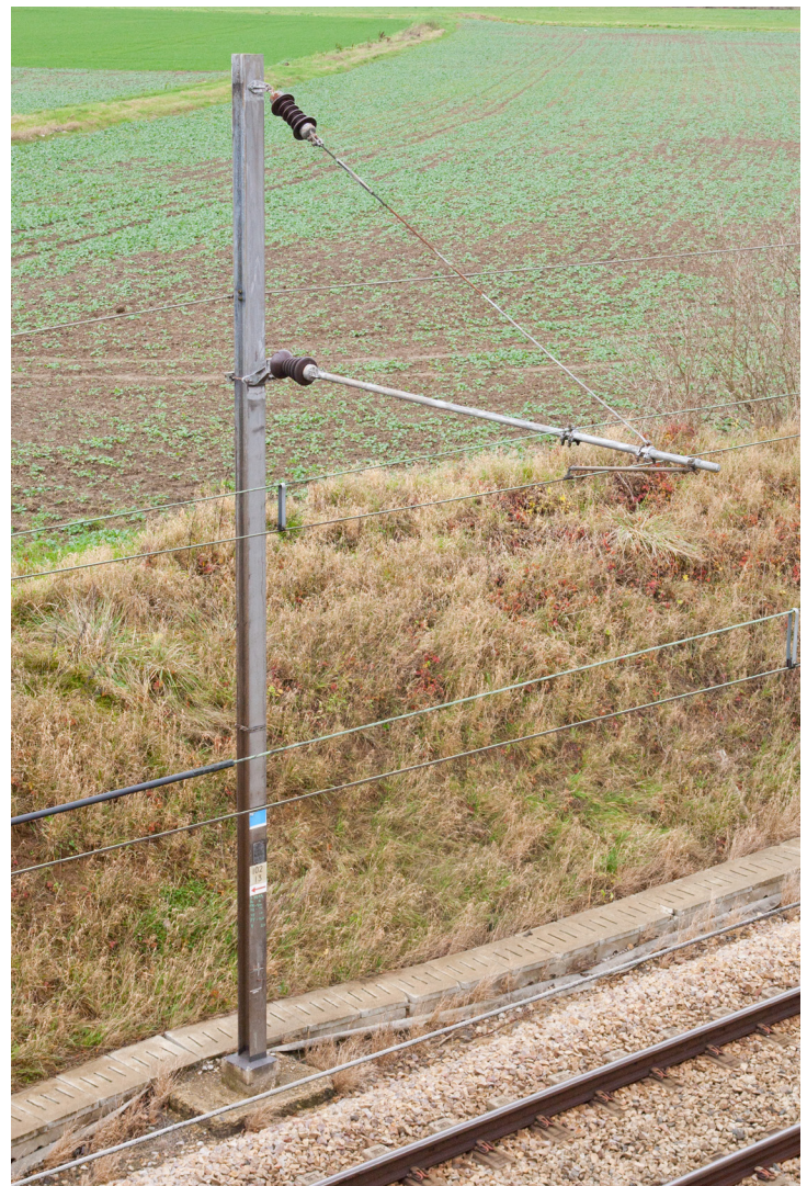
Un exemple réel vu sur la ligne Creil/St-Quentin et correspondant parfaitement à notre référence 3604 montée en compression avec un encombrement de 3,5 mm.
