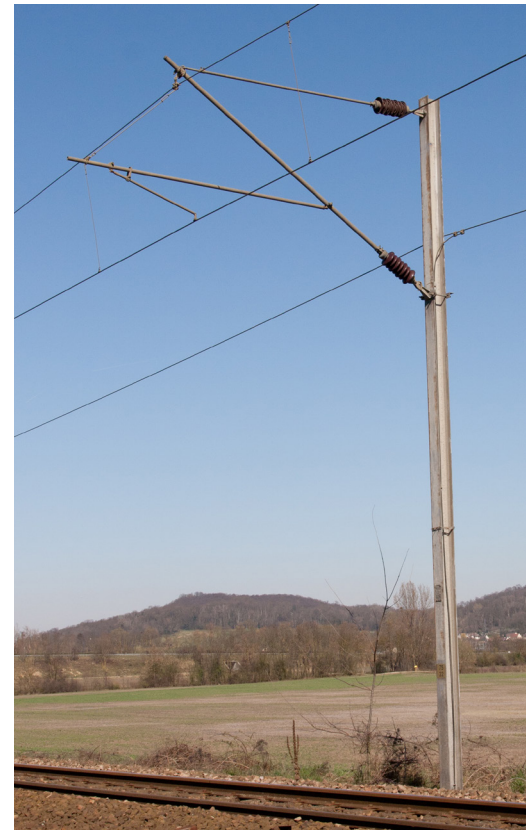
Ce support, situé en pleine ligne, est équipé d'un armement en compression.
