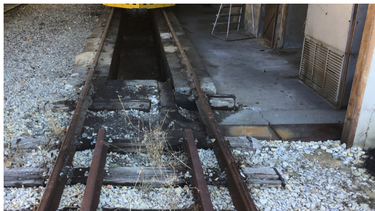
Vue de détail sur le conduit d'aspiration partant de la fosse. Notez que la dernière traverse est coupée pour laisser le passage libre.
